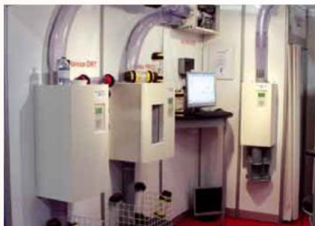
Ukázka stanic systému potrubní pošty
